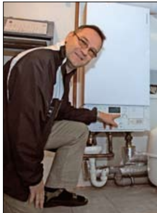
Vermieter Tilo Merkel vor seiner neuen Erdgas-Brennwerttherme.
